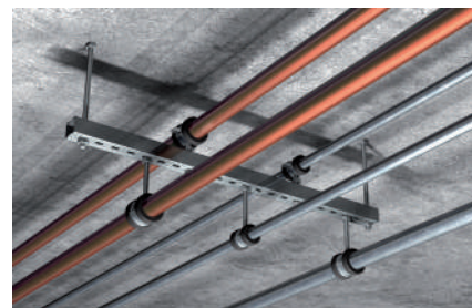
Instalacje sanitarne i przemysłowe
