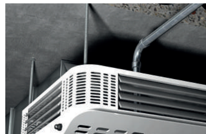
Podwieszenie urządzeń klimatyzacyjnych
