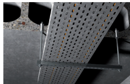
Trasa kablowa mocowana do płyt kanałowych
